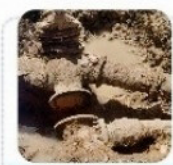
شکستگی لوله و تجمع آب
